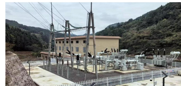
重庆万州大滩口水库二级电站
